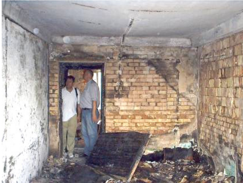
Рисунок 4 – Стан зовнішніх шарів внутрішньої поздовжньої та поперечної стін і полиці шатрової плити перекриття
