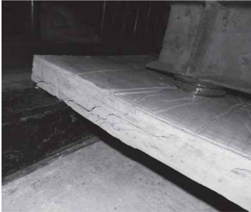
Рис. 5 – Руйнування опорної зони плити
