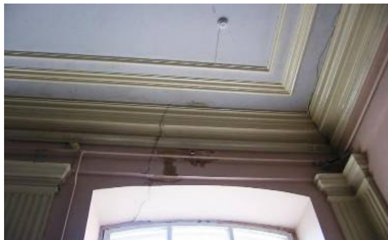
Рис. 5. Трещины в районе крайнего окна шириной раскрытия 3 ... 6 мм
