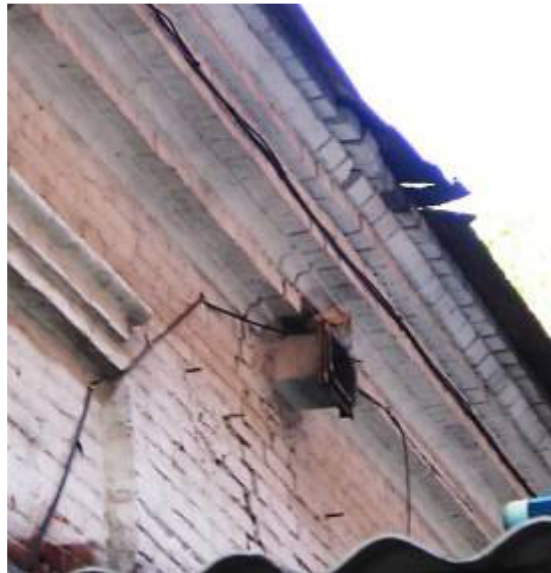
Рис. 4. Сквозная трещина над дверным проемом в стене по оси «Д'» с наружной стороны зала
