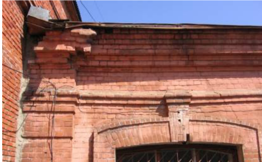
Рис. 3. Трещина в клинчатой кирпичной перемычке над крайним окном стены по оси «8/1» (видно примыкание зданий)
