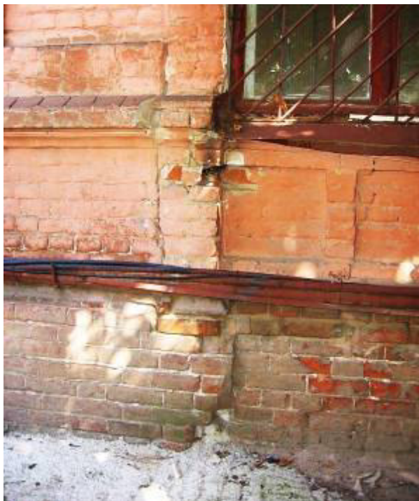
Рис. 6. Вертикальные трещины в подоконном пространстве 3-го окна шириной раскрытия до 1 мм и частичное разрушение кирпичной кладки цоколя
