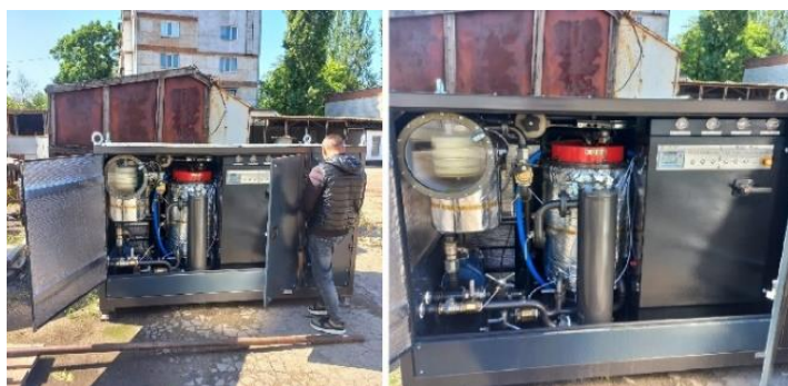
Рис. 7. Дегазаційна установка для відновлення трансформаторної оливи
