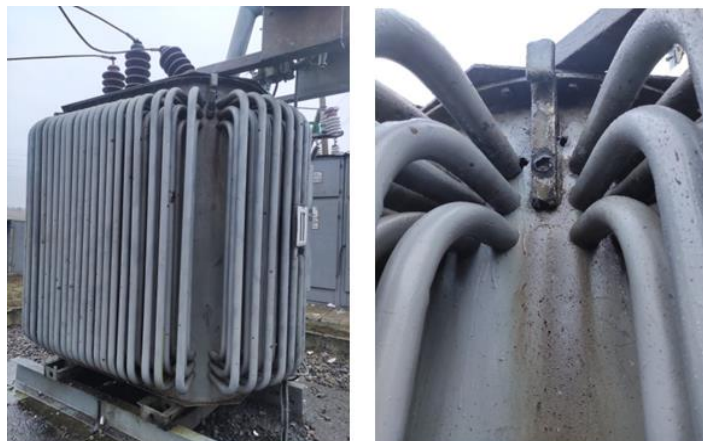
Рис. 6. Трансформатори з ушкодженими контурами охолодження
