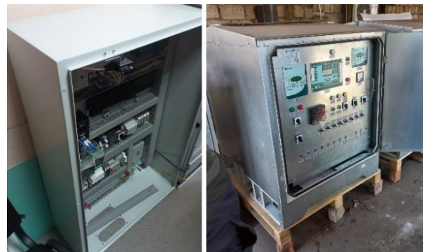
Рис. 5. Телекомунікаційна шафа дистанційного керування роботою підстанцій
