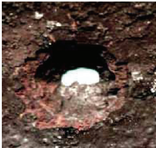
Рисунок 1 – Типовий вид корозійних виразок, що утворилися на поверхні НКТ в процесі експлуатації на родовищах компанії «Нафтогазвидобування»
